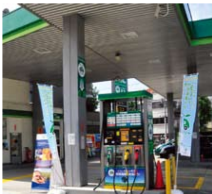
Posto em Kawasaki tem duas bombas com E3 かなせき(川崎市)のサービスステーションにE3用給油機2基設置
